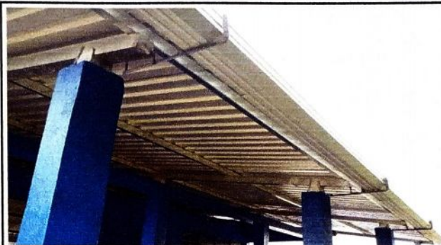
Foto 8: vista Frontal del establecimiento, la instalación de canales troquelados para bajada de agua pluvial del centro educativo.
